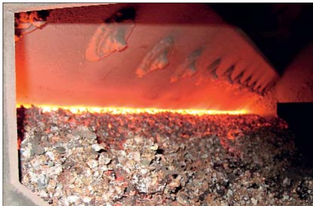
Kühlbrücke/Wassertasche in einem Füllschachtkessel.
