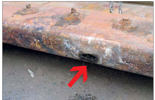
Durchgebrannte Kühlbrücke. Fotos: M. Klunke/Gartenbau-Versicherung
