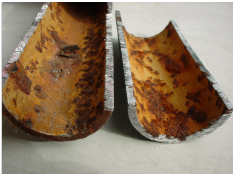
Abb. 1: Innen verrostete Rohre (Quelle: Tanner Wasseraufbereitung, Reigoldswil)
