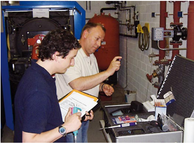
Eine Heizwasseranalyse vor Ort gibt Aufschluss über die Wasserqualität und bildet die Grundlage für allfällige Massnahmen. (Bilder: Elysator)
